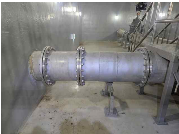
<유입밸브실 송수관로 상태양호>
