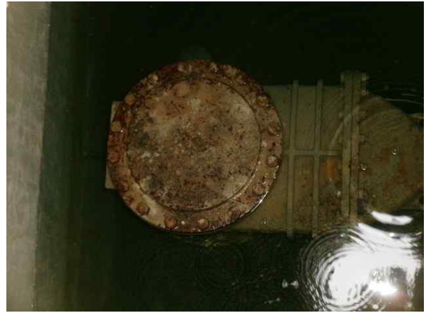
<송수관로 Sta.3+16.1(점검구) 점부식>
