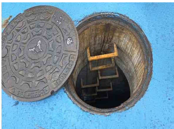
<송수관로 점검구(B1-1) 사다리 설치 상태양호>
