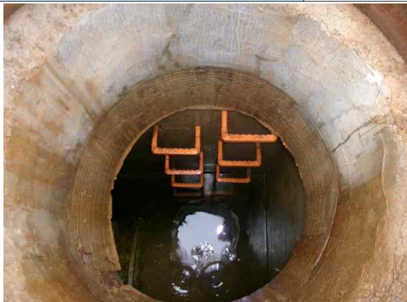
<송수관로 Sta.17+1.5(점검구) 침수(H=1.5m)>
