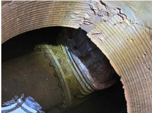
<송수관로 Sta.17+1.5(점검구) 볼트 부식>
