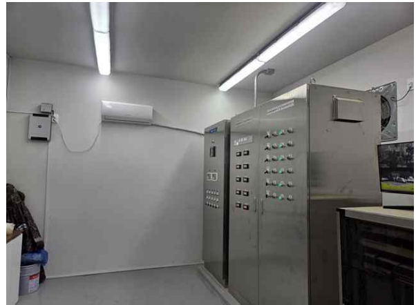
<전기실 내부 상태양호>>
