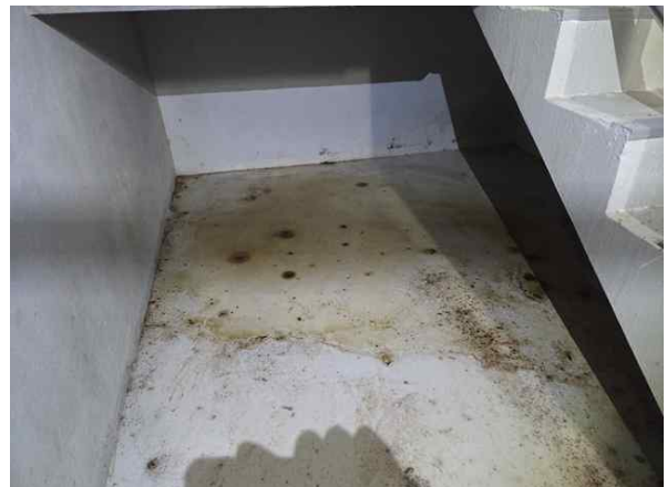
<계단실 내부 체수흔적>
