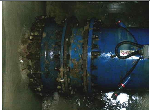
<송수관로 Sta.4+0.0(유량계실) 볼트 부식>
