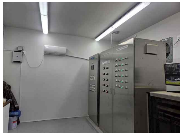
<전기실 내부 전경>
