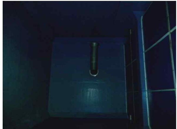
<배수지 2지 전경>
