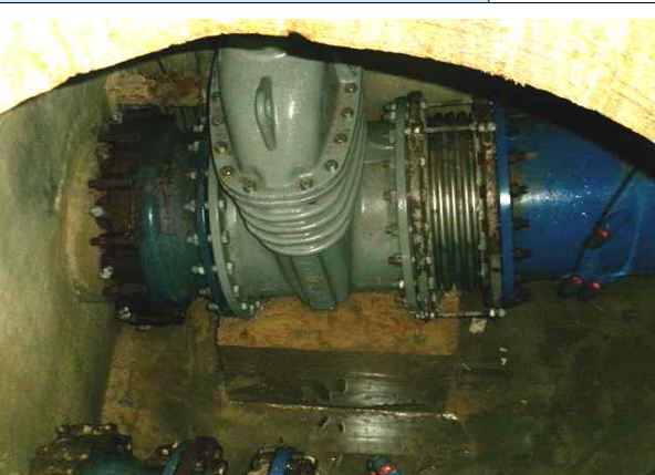
<송수관로 Sta.4+0.0(유량계실) 유입신축관 볼트 부식>
