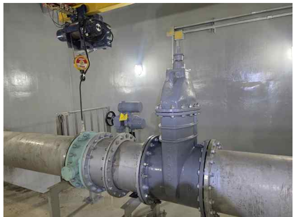
<유입밸브실 유입밸브 상태양호>
