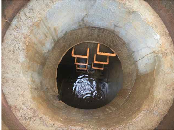
<송수관로 점검구(B1-2) 사다리 설치 상태양호>
