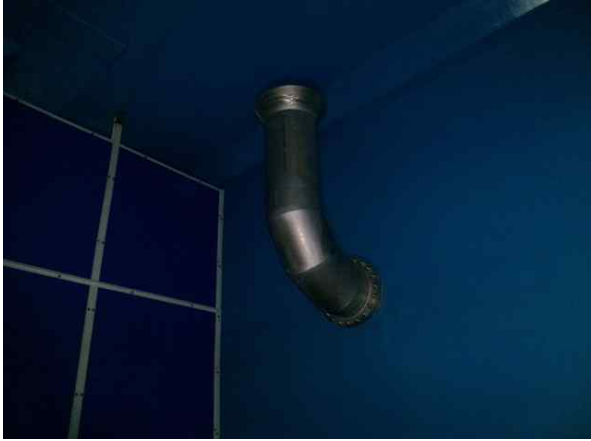
<1지 유입배관 상태양호>
